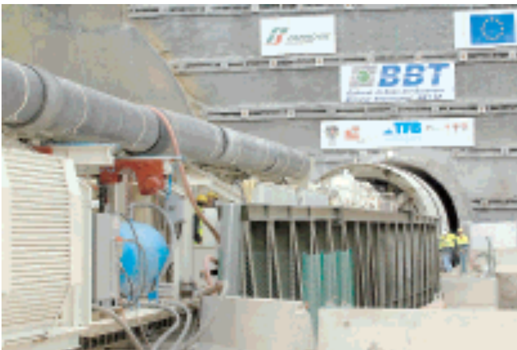
Uno dei cantieri aperti per la realizzazione del nuovo tunnel del Brennero
